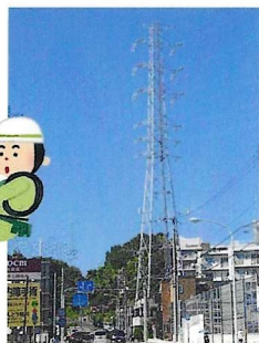
川世線35 昭和56年 6月建設、高さ59m
