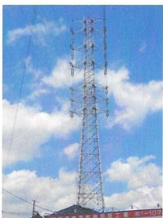
川世線33 昭和55年 9月建設、高さ60m
